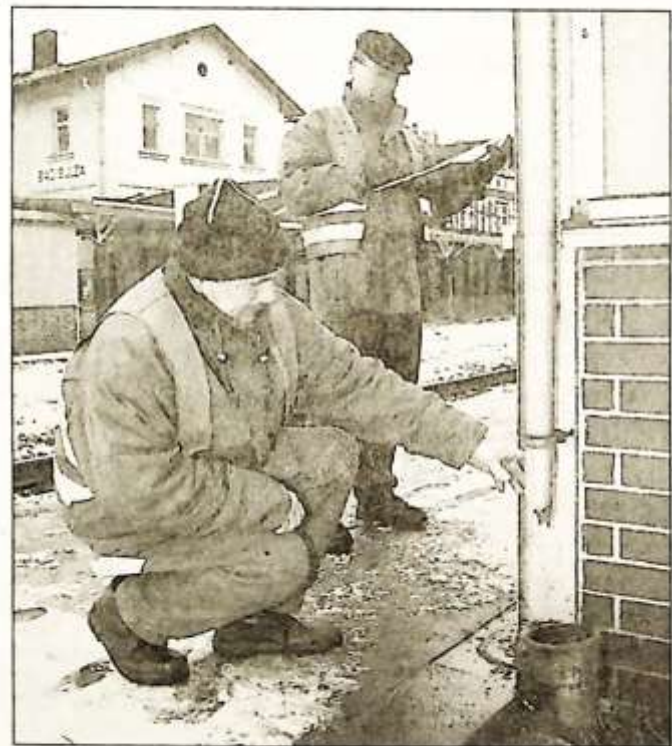
INSPIZIERT: Den Bahnhof Bad Sulza haben gestern Ingolf Wagner (v.) und Hartwig Römer begutachtet. Alle sechs Jahre führt die Bahn AG an ihren Gebäuden eine Regeluntersuchung durch
